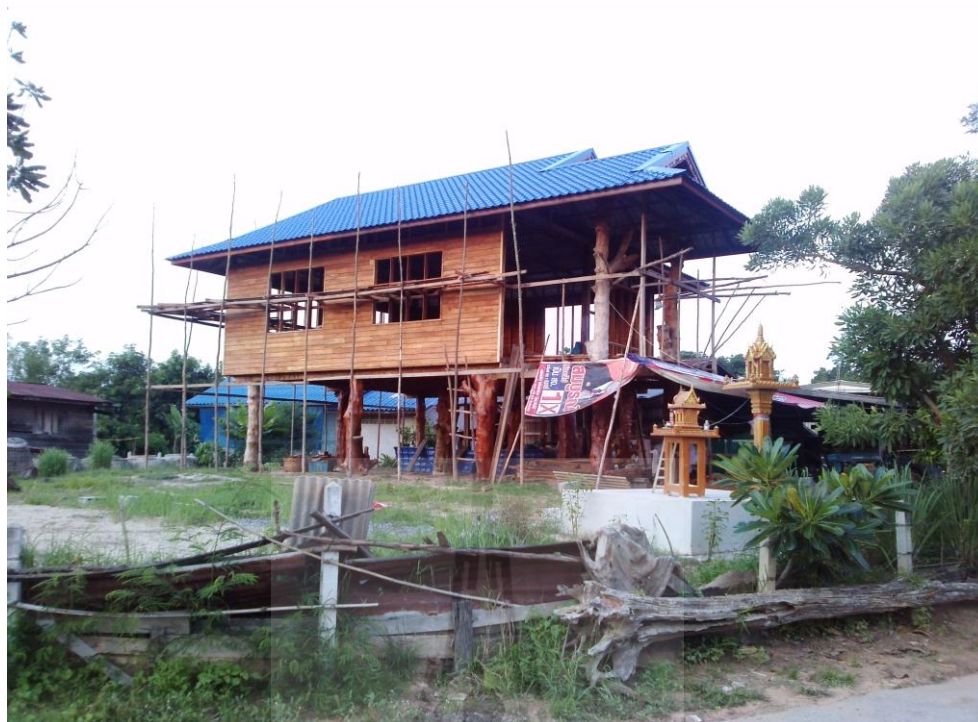
รูปที่ 1.2 อาคารพักอาศัยที่กำลังก่อสร้างในเขตตำบลโบสถ์
