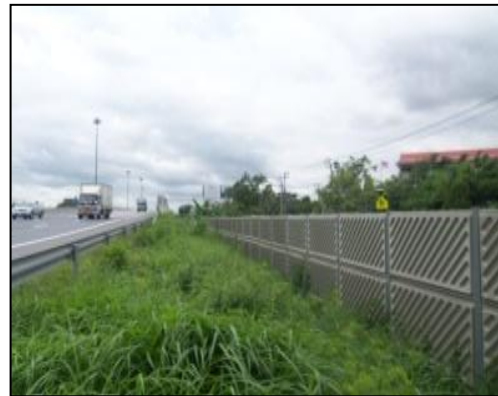
ช่องกำแพงที่ติดตั้งระดับพื้นถนน
