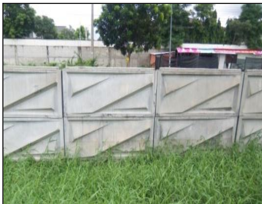
กำแพงเสียงดังชนิด GRC ซึ่งติดตั้งต่ำกว่า
