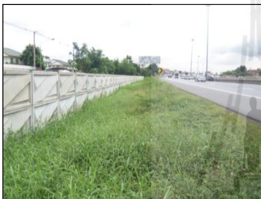
การติดตั้งที่ต่ำกว่าระดับถนน
