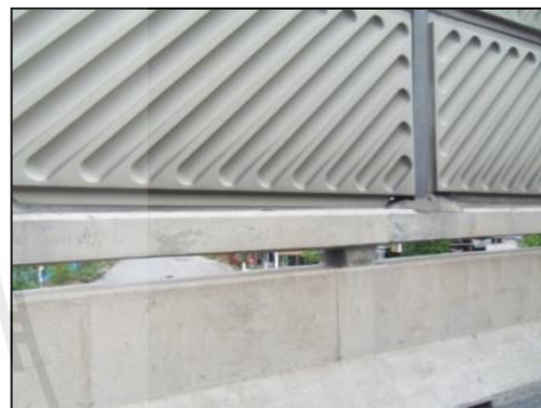
ช่องว่างใต้กำแพงจากการติดตั้ง
