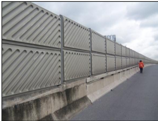
กำแพงกันเสียงชนิด FRP
