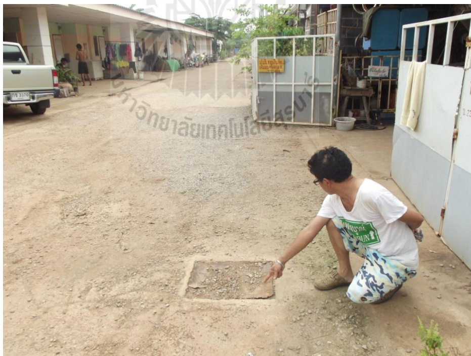
รูปที่ 5.3 ท่อระบายน้ำที่ฝังภายในหมู่บ้านชัยจินดา
