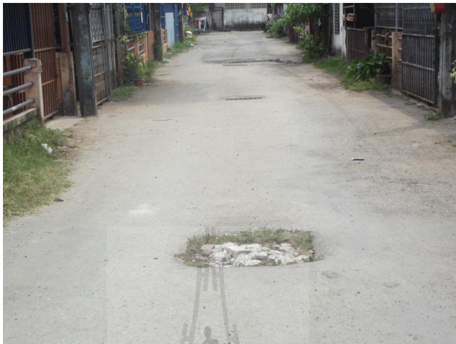
รูปที่ 5.2 ท่อระบายน้ำที่ฝังภายในหมู่บ้านเซนการ์เดินโฮม
