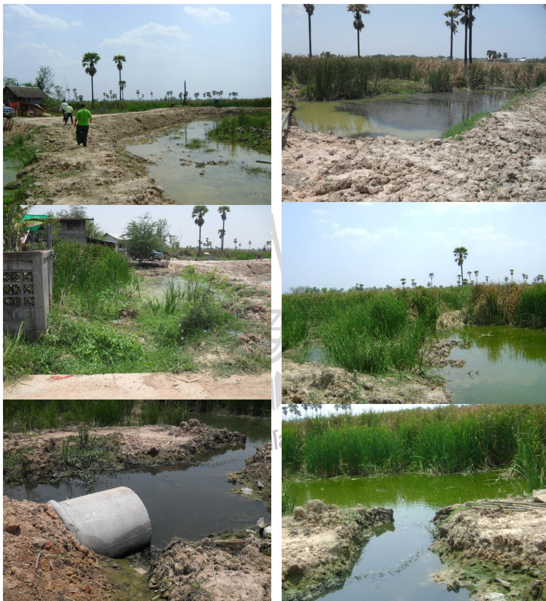
รูปที่ 5.1 พื้นที่ในการก่อสร้างระบบบำบัดน้ำเสีย 1
