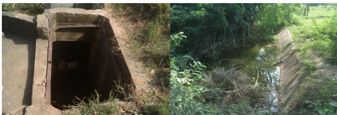
รูปที่ 3.11 บริเวณโครงการก่อสร้างรางระบายน้ำคอนกรีตเสริมเหล็กปัจจุบัน
