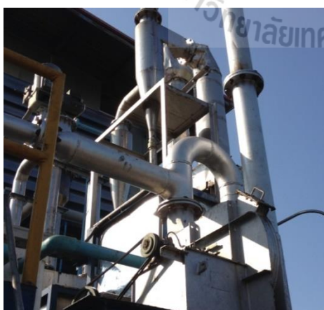
ฅ. พัดลมดูด (Gas blower)
