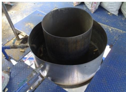
ก. Hopper Feeder ป้อนเชื้อเพลิง
