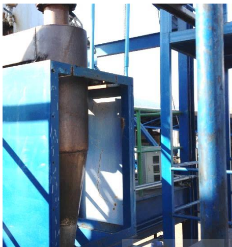
จ. ไซโคลนดักฝุ่น (Cyclone collector)
