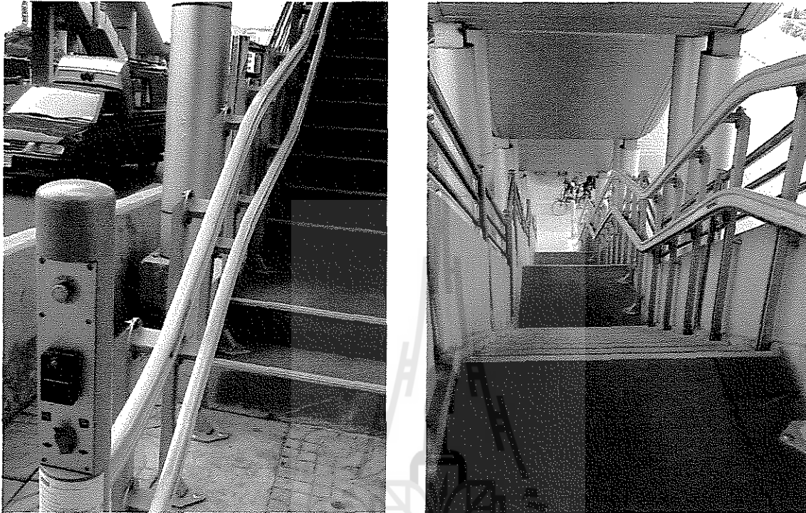
รูปที่ 2.33 ลิฟต์ติดบันไดสำหรับเก้าอี้ล้อเลื่อนขึ้น-ลงสถานีรถ BRT
