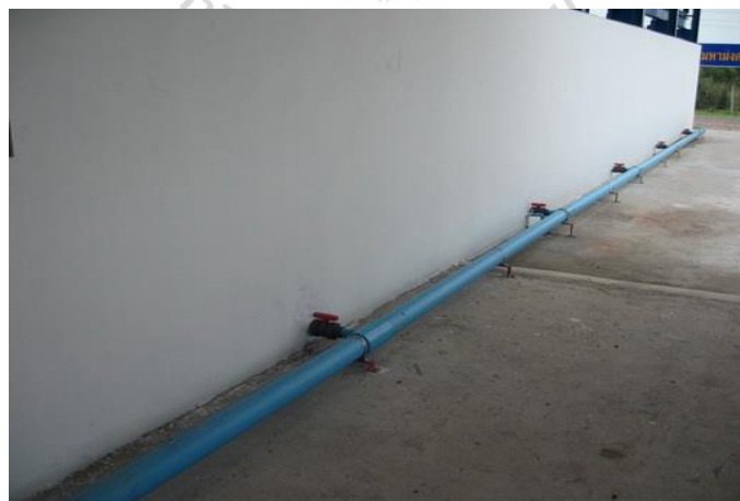
รูปที่ 4-10 การเติมอากาศโดยใช้ท่อพีวีซีเชื่อมต่อกับปั๊มลม (Air Blower)
