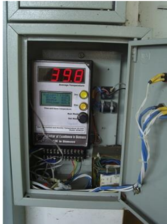
รูปที่ 4-16 การอ่านค่าอุณหภูมิของปุ๋ยโดยใช้ Thermocouple ระบบอัตโนมัติ
