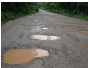
รูปที่ 1 ความเสียหายของถนนที่需要进行ซ่อมแซม
