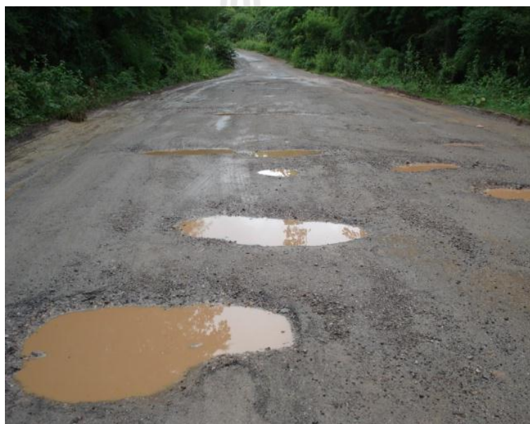
รูปที่ 1.1 ตัวอย่างความเสียหายของถนนที่ต้องการซ่อมแซม
