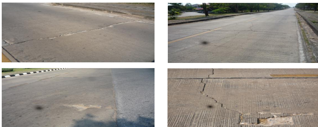
รูปที่ 3.3 ลักษณะความเสียหายยังไม่ได้รับการซ่อมแซม
