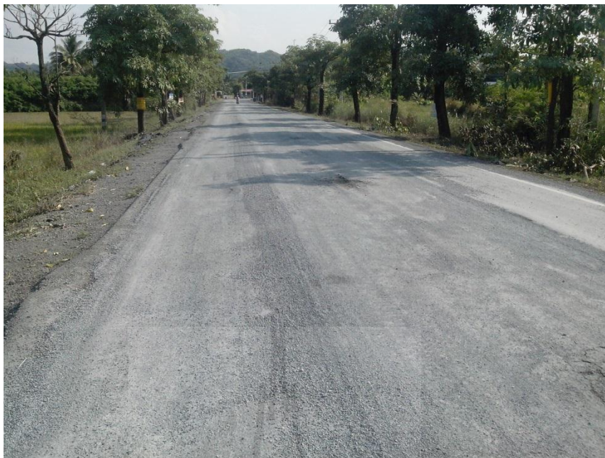
รูปที่ 1.1 สภาพความเสียหายของถนน
