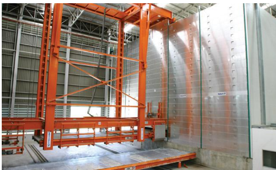
รูปที่ 2.9 การบ่มคอนกรีตด้วยระบบเตาอบ ( Prukasa Real Estate , 2006)
