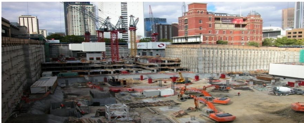
รูปที่ 2.1 การใช้งานทรัพยากรต่างๆในพื้นที่ก่อสร้าง
