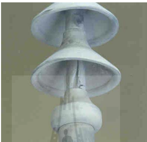
รูปที่ 3.16 การเกิดร่องผิวเสื่อมสภาพจากวาบไฟ (Jeff, 1998)
