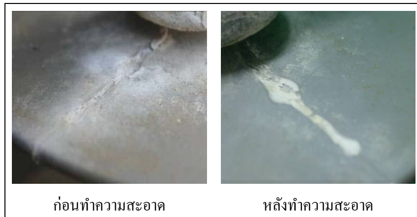
(ง) ร่องผิวเสื่อมสภาพจากวาบไฟบริเวณรอยตะเข็บบนปีกยางซิลิโคน
