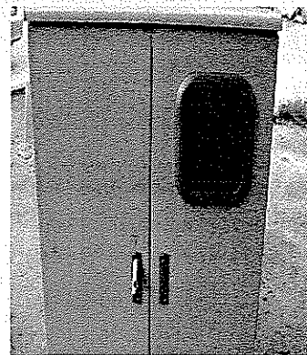
(จ) ระบบควบคุม (Electric control panel)
