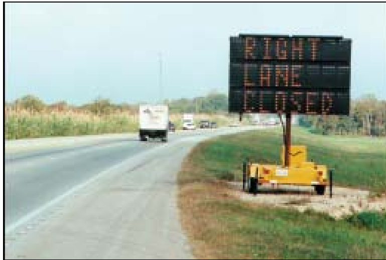
รูปที่ 2.4 การควบคุมการจราจรบริเวณพื้นที่ก่อสร้างโดยใช้การเปลี่ยนรูปแบบของข้อความบนป้ายจราจรอิเล็กทรอนิกส์
