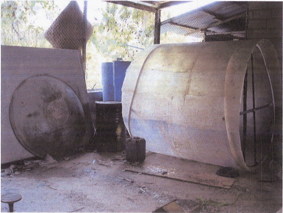
รูปที่ 4 การทำถังไฟเบอร์กลาสสำหรับระบบบำบัดน้ำเสีย
