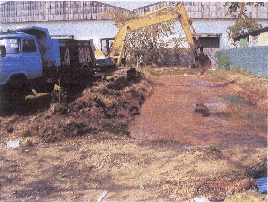
รูปที่ 2 การปรับพื้นที่ก่อสร้างระบบบำบัดน้ำเสีย
