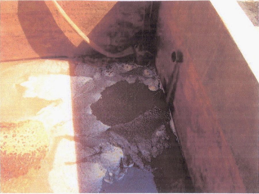
รูปที่ 13 น้ำเสียใน EQ Tank
