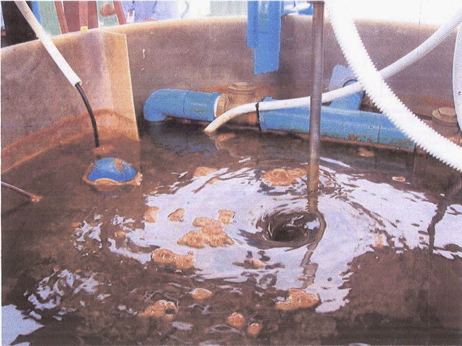
รูปที่ 14 ลักษณะน้ำเสียในถังปรับ pH
