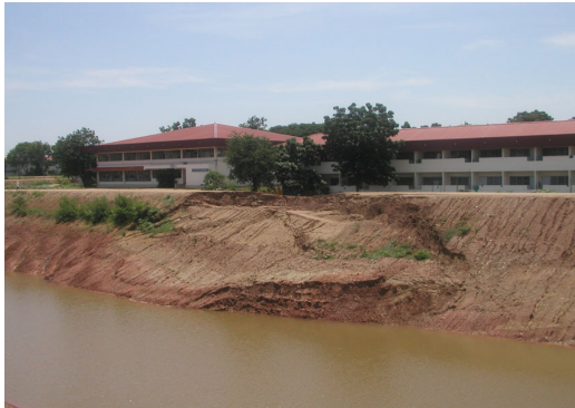
ภาพที่ 1 การวิบัติของลาดดินอ่างเก็บน้ำเนื่องจากชั้นดินเหนียวบวมตัวแทรกแบบเอียงตัวอยู่ในชั้นดินเหนียวแข็ง
