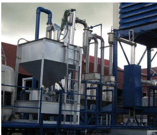
ช. ถังบำบัดน้ำเสีย (Flocculation Tank)
