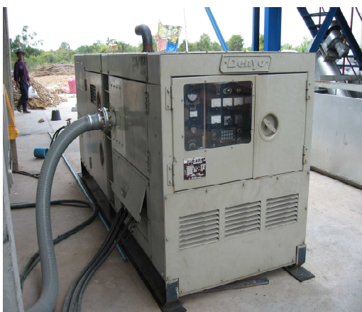
ฉ. Diesel – Engine Generator Set (ยี่ห้อ KOMUTSU : 6 สูบ 125 KVA)
