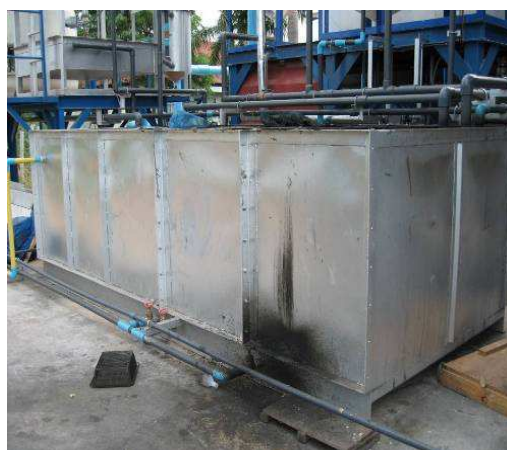
ฉ. ถังรวบรวมน้ำเสีย (Buffer Tank)
