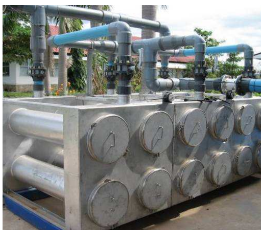
จ. ระบบกรอง (Fabric Filter Unit)
