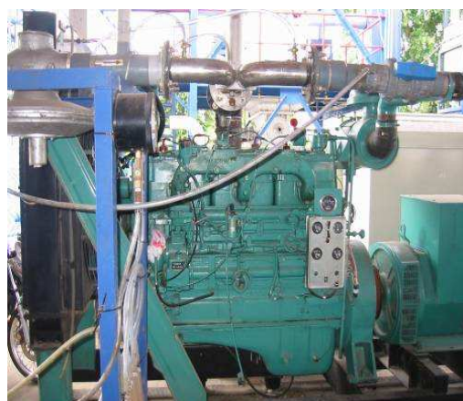
ญ. Gas – Engine Generator Set (ยี่ห้อ CUMMINS : ขนาด 6 สูบ 115 KVA)
