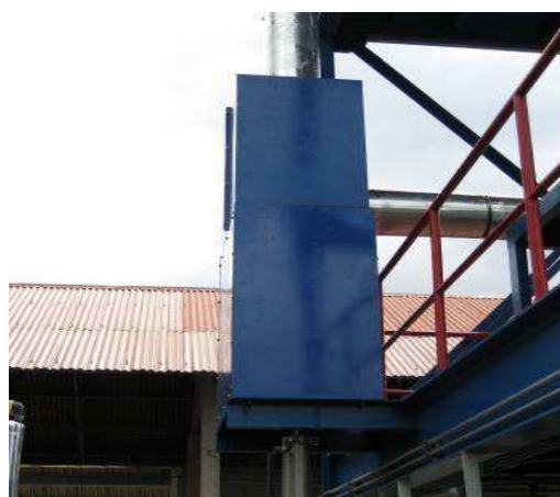
ข. ไซโคลนดักฝุ่น (Cyclone Collector)
