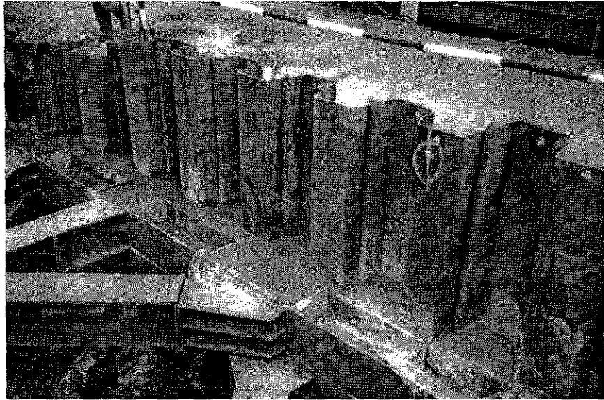
รูปที่ 6.28 การเทคอนกรีตบริเวณช่องว่างระหว่าง Wale กับแผงเข็มพืดเหล็ก
