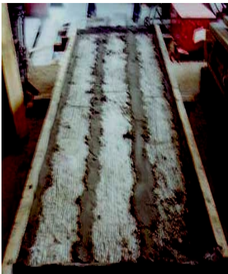
รูปที่ 3.8 การเตรียมชิ้นส่วนพื้นคอนกรีตอัดแรงสำเร็จรูปเป็นระบบพื้น
