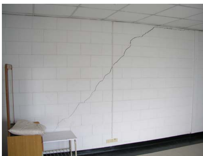
รูปที่ 1.1 รอยแตกร้าวที่ผนังของอาคารหอพักสุรนิเวศ 9
