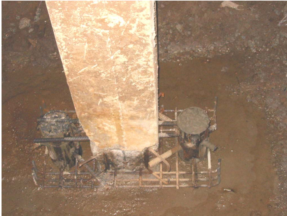
รูปที่ ค.7 การประกอบเหล็กเสริมของฐานรากใหม่
