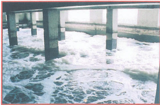
รูปแสดง ถังเติมอากาศ
