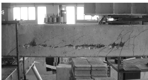
(b) คานที่มีระยะฝังเหล็กทรงน้ำเท่ากับ 110 และ 140 ซม.
