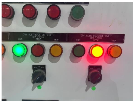
รูปที่ 3.8 สวิตช์สตาร์ทปั๊มน้ำ DIW Booster
