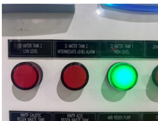
รูปที่ 3.2 ไฟแสดงระดับน้ำในถังเก็บน้ำดีไอโอไนซ์
