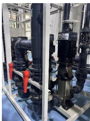
รูปที่ 3.7 ปั้มน้ำ DIW Booster
