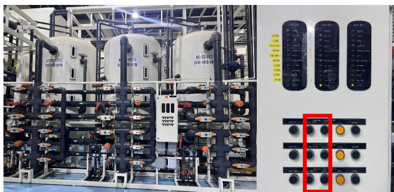
รูปที่ 3.5 ถังกรอง และตู้ควบคุมการทำงานวาล์ว MIXED BED RESIN
