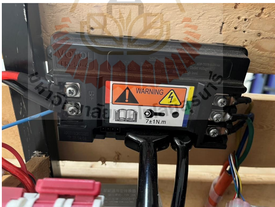
รูปที่ 6.6 กล่องควบคุมมอเตอร์
