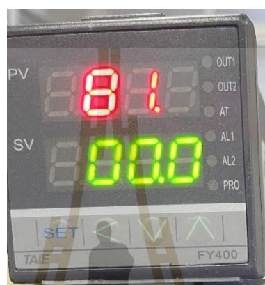
รูปที่ 4.13 แสดงอุณหภูมิของระบบการเป่าลมร้อนที่กำลังงาน 3,756W ได้อุณหภูมิ 81 องศาเซลเซียส
