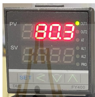
รูปที่ 4.7 แสดงอุณหภูมิของระบบการเป่าลมร้อนที่กำลังงาน 3,756W ได้อุณหภูมิ 80.3 องศาเซลเซียส
