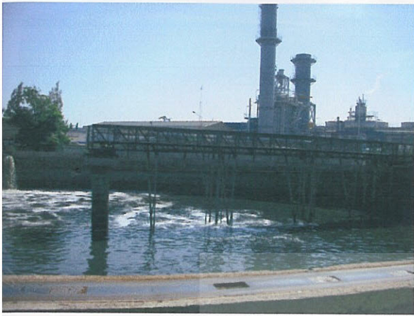
Equalization Tank บ่อปรับสภาพ
