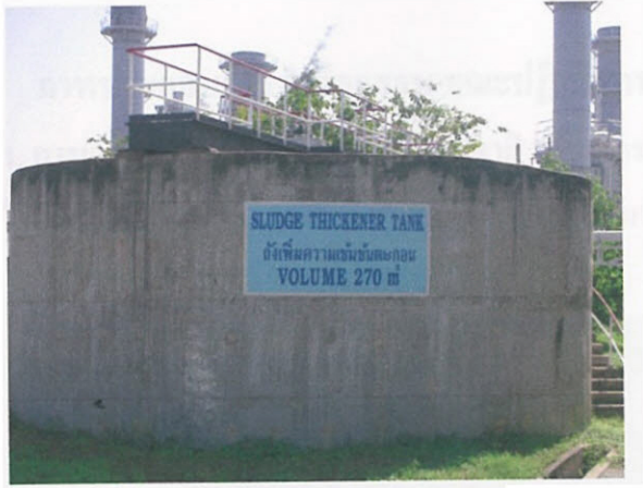
Sludge Thickener Tank ถังเพิ่มความเข้มข้นตะกอน
