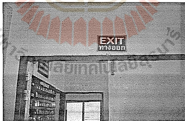
ภาพที่ 1 ทางออกฉุกเฉินบริเวณทางเข้าออกอาคารชั้นล่าง
