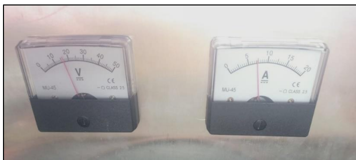
รูปที่ 4.6 แรงดันที่ใช้ 18 v กระแส 7 A กำลังงานที่ปล่อยไปยังสายอากาศอยู่ที่ 126 W
