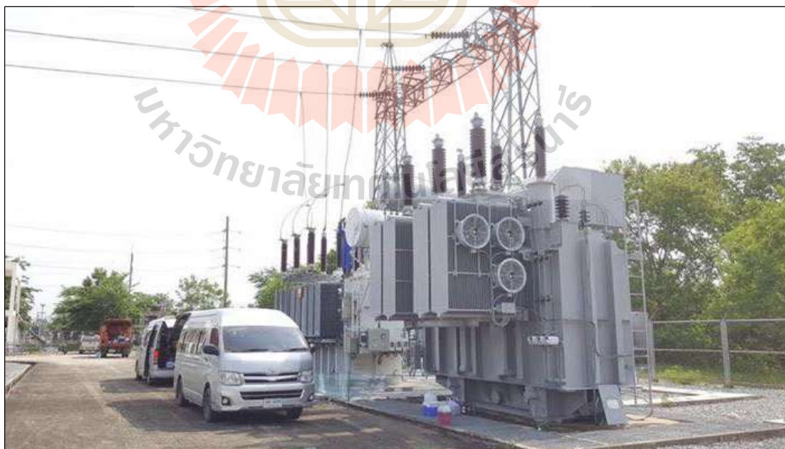
รูปที่ 2.13 หม้อแปลงกำลัง 25 MVA ภายในสถานีไฟฟ้าย่อยจำหน่ายของ กฟภ.
