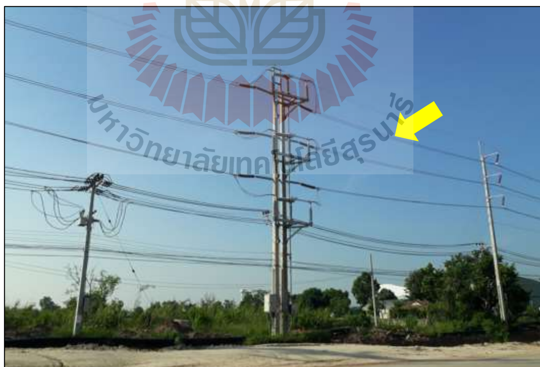
รูปที่ 2.10 สายส่งย่อย 115 kV ของ กฟภ. บริเวณทางหลวงแผ่นดินหมายเลข 2
