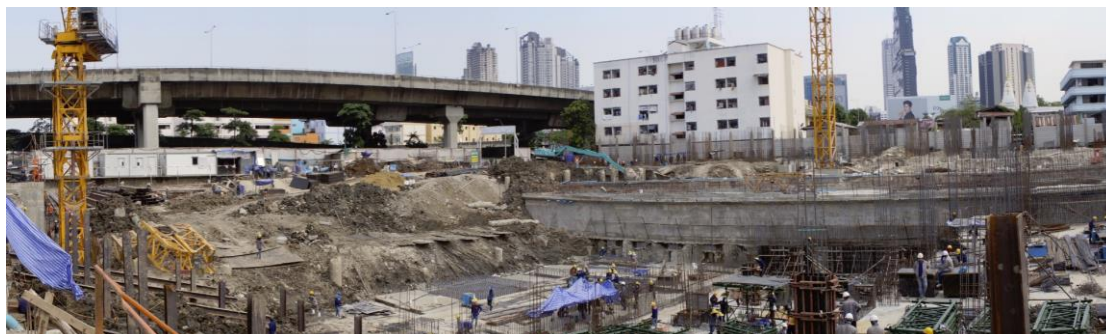
รูปที่ 4.4 ภาพถ่ายโครงการ
