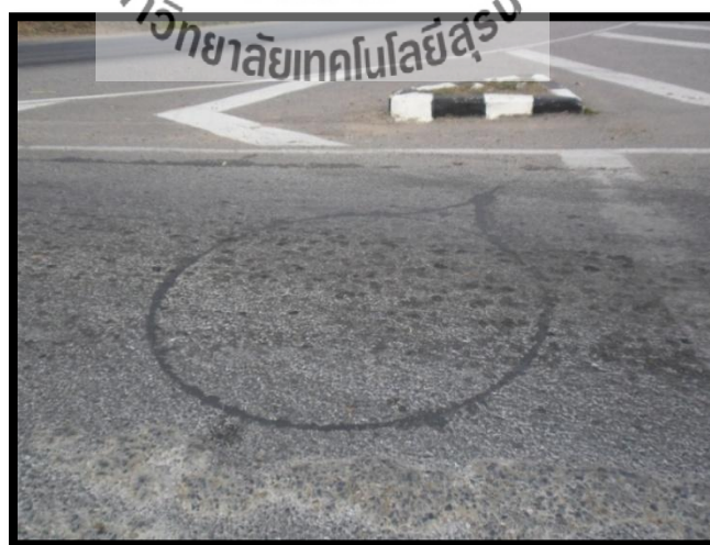
รูปที่ 4.6 รูปเหนี่ยวนำที่ติดตั้งที่พื้นถนน
