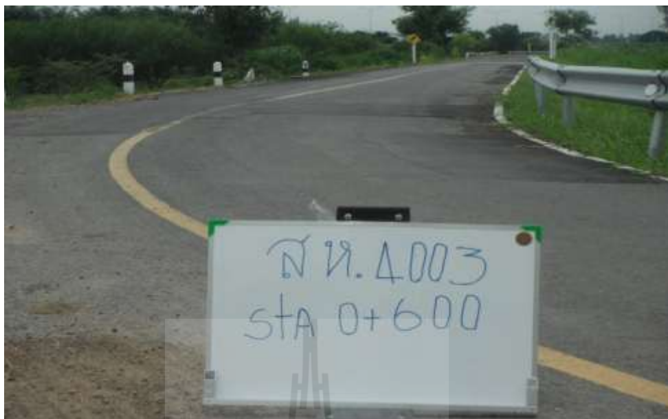
รูปที่ 3.3 ลักษณะความเสียหายของถนน กม.ที่ 0 + 600 ทางหลวงชนบทสาย สท. 4003 จังหวัดสิงห์บุรี
