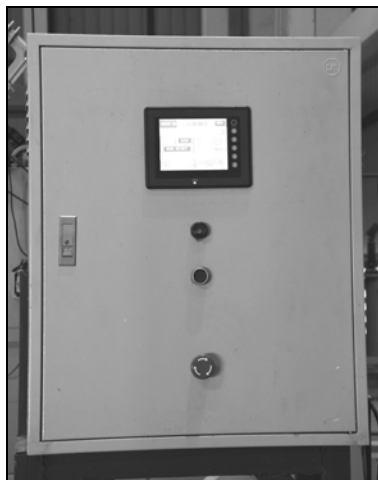
รูปที่ 4.20 ชุดควบคุมการทำงานของมอเตอร์
