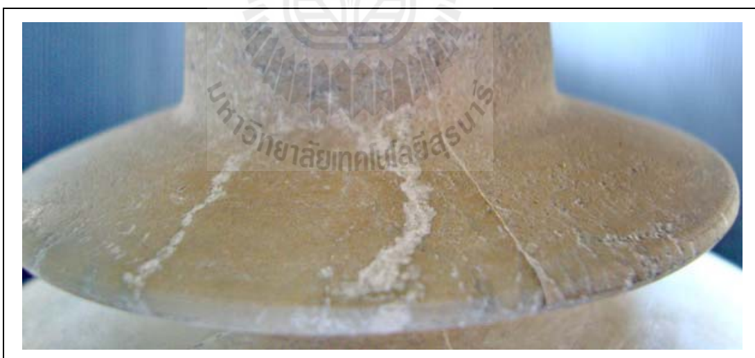
(ข) การกักตร้อนบนพื้นผิวบริเวณปีกเล็กกลางลูกถ้วยฉนวนพอลิเมอร์ปีกลับ-เอียงชนิดแข็ง
