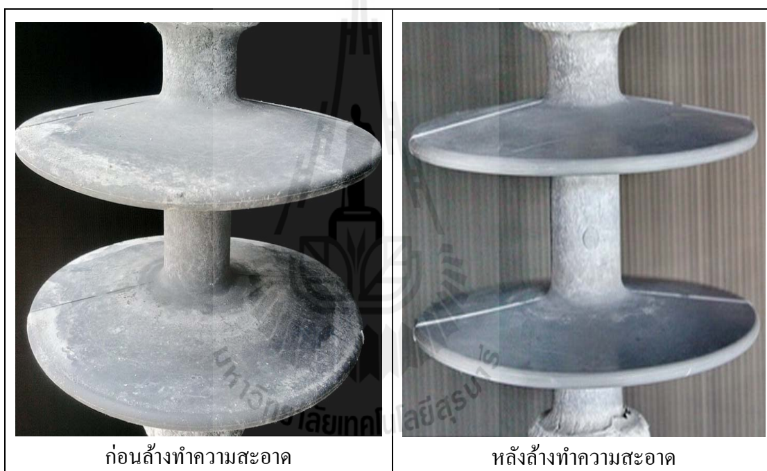
(ก) ลักษณะลูกถ้วยฉนวนพอลิเมอร์ปีกตรงหลังการทดสอบ
